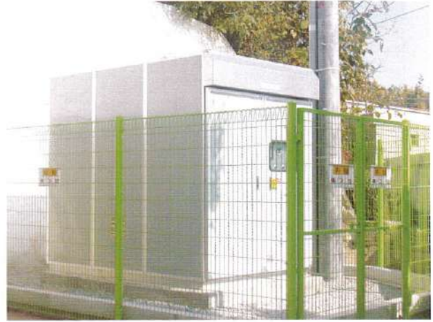
단열 수/배전 설비 측면 (상주교육청)
