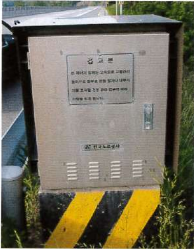
제어기함 외부 이중함(도로공사)
