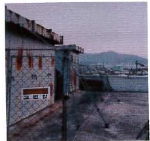
몇년 후 부식 및 도장 상태
